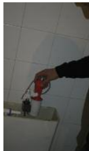
También se han instalado mecanismos de ahorro de agua en los sanitarios
